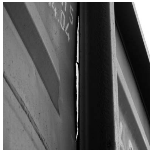
Рисунок 2 – Развитие трещины в месте отрыва листа обшивки от шкворневой стойки
