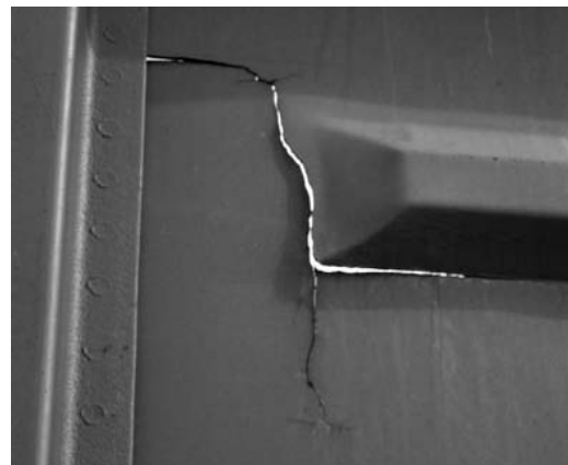
Рисунок 1 – Развитие трещин по углу гофра (2 панель)
