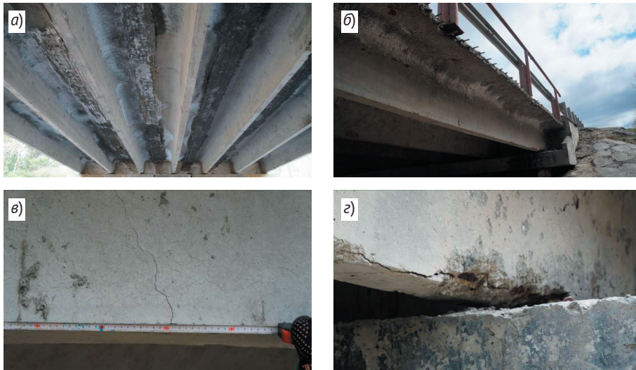
Рис. 2. Дефекты и повреждения железобетонных пролетных строений мостов а – выщелачивание цементного камня; б – морозное разрушение бетона; в – нормальные и наклонные трещины в растянутой зоне главных балок; г – разрушение защитного слоя бетона от продуктов коррозии рабочей арматуры
