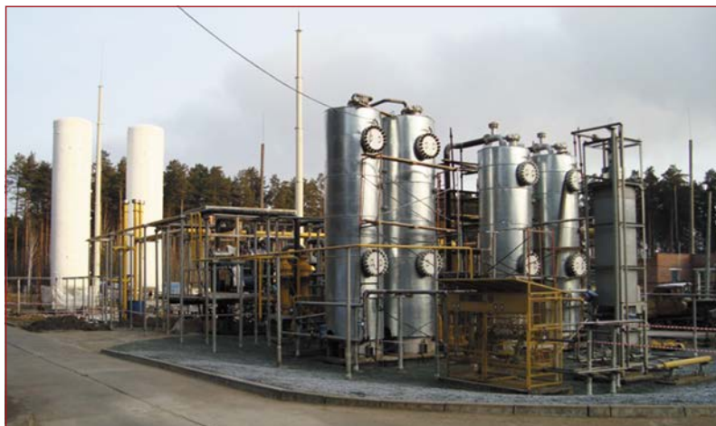
Рис. 4. Комплекс по производству СПГ на ГРС-4 г. Екатеринбурга, ООО «Газпром трансгаз Екатеринбург»
